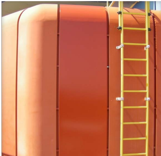
▲ Bild 22: Metallfassade pulverbeschichtet, 15 Jahre nicht gereinigt mit Reinigungsmusterfläche
