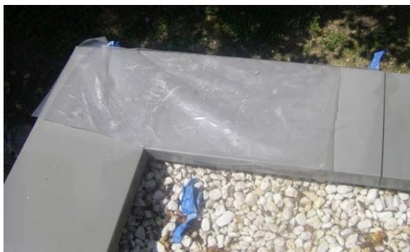
▲ Bild 14: Wasserflecken, Folie noch vorhanden Fleckenbildung auf einem Aluteil durch längere Lagerung in Folie im Freien
