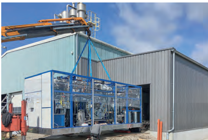
Vor zehn Jahren installierte die Richard Geiss GmbH die Pero-Anlage für die Lohnreinigung (Bild: Richard Geiss)
