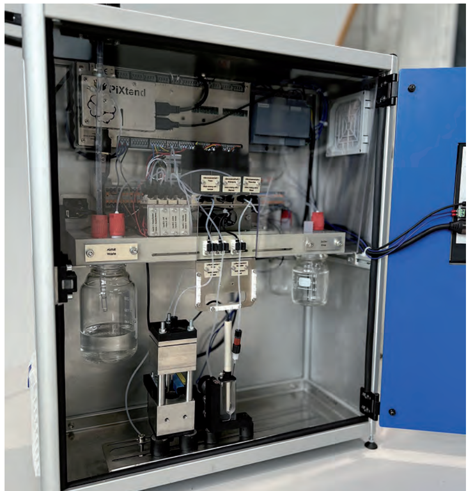
Eine stabil hohe Prozessqualität und Einsparungen bei Energie, Ressourcen und Betriebskosten ermöglicht das innovative LOC-System durch automatisierte Analysen der Reinigungs- und Spülstufen auf Basis verschiedener Messverfahren (Bild: Ecoclean)
