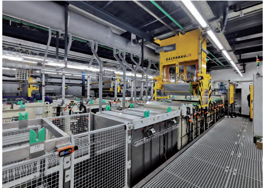
Neue Galvanikanlage der GALVABAU AG bei Pilatus Flugzeugwerke AG
