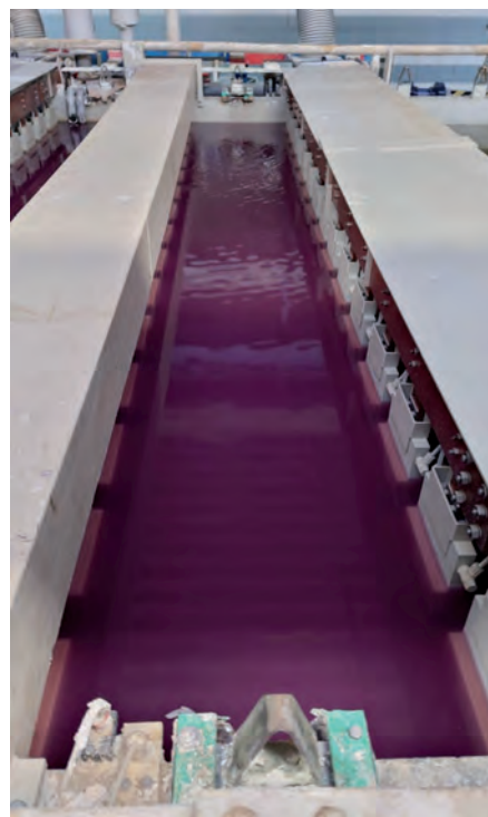
Abb. 2: CMA-Installation mit Elektrolyt
