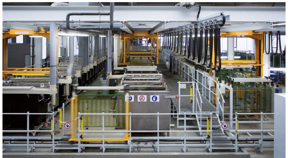
Moderne Galvanikanlage zur hochqualitativen Beschichtung von hohen Stückzahlen beziehungsweise Losgrößen
