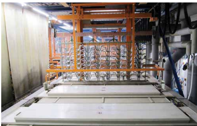
Blick auf die neue Anlage bei SMK
