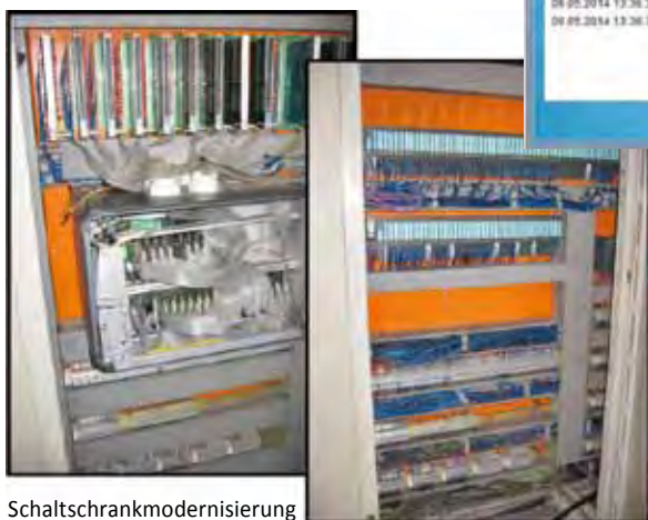
Schaltschrankmodernisierung – vor und nach der Überarbeitung
