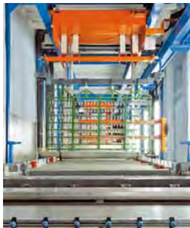
Neue Anlage bei Hartchrom GmbH 45
