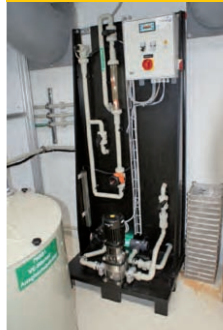
Abb. 10: Ionenaustauscheranlage zur Kreislaufführung von Spülwässern mit externer Regeneration der beladenen Harze
