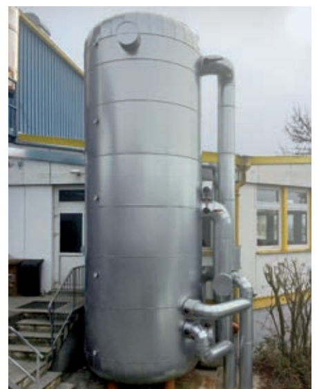
Der 20 000 Liter fassende Pufferspeicher nimmt Wärmeüberschüsse in den Sommermonaten auf
