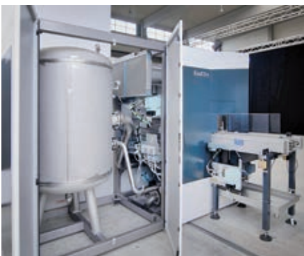
Beim neuen Trocknungssystem wird das Vakuum in den Nebenzeiten erzeugt; dadurch werden sehr kurze Taktzeiten erreicht Bild: Dürr Ecoclean
