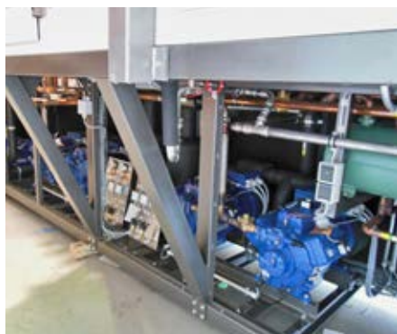
Blick auf die Verdichter unter der Kälteanlage
